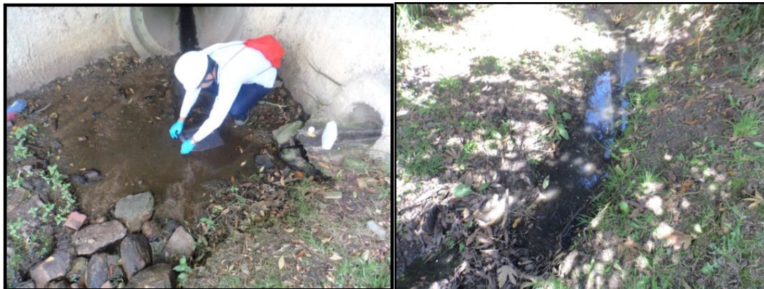
Fotografías 1 y 2. Aguas arriba (izquierda) y Abajo (derecha) del Vertimiento
